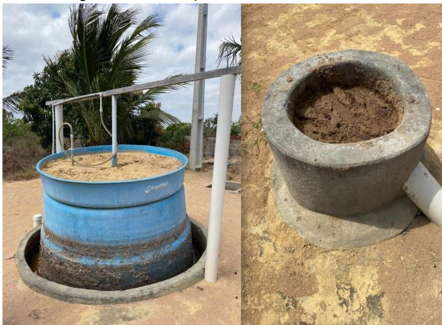
Figura 03 - Biodigestor instalado pela Cáritas Diocesana de Caicó na Macambira
