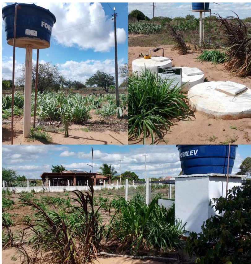
Figura 02 - Bioágua instalado pela Cáritas Diocesana de Caicó na Macambira
